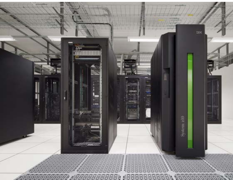
Vue intérieure d'une salle du Datacenter
